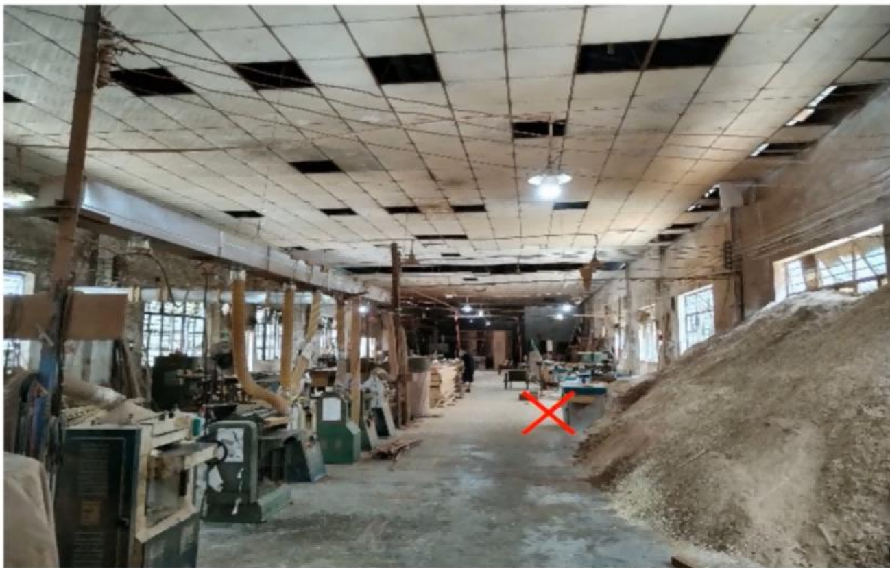
车间堆积粉尘严重
