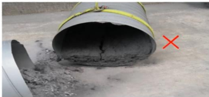
设备、管道内部积尘严重
