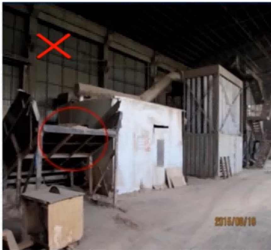
粉碎前未安装除铁器
