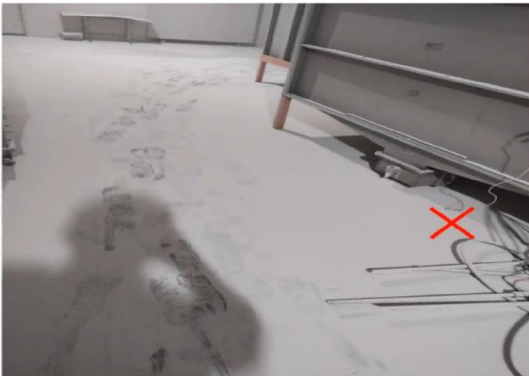
静电喷涂房内积尘严重
