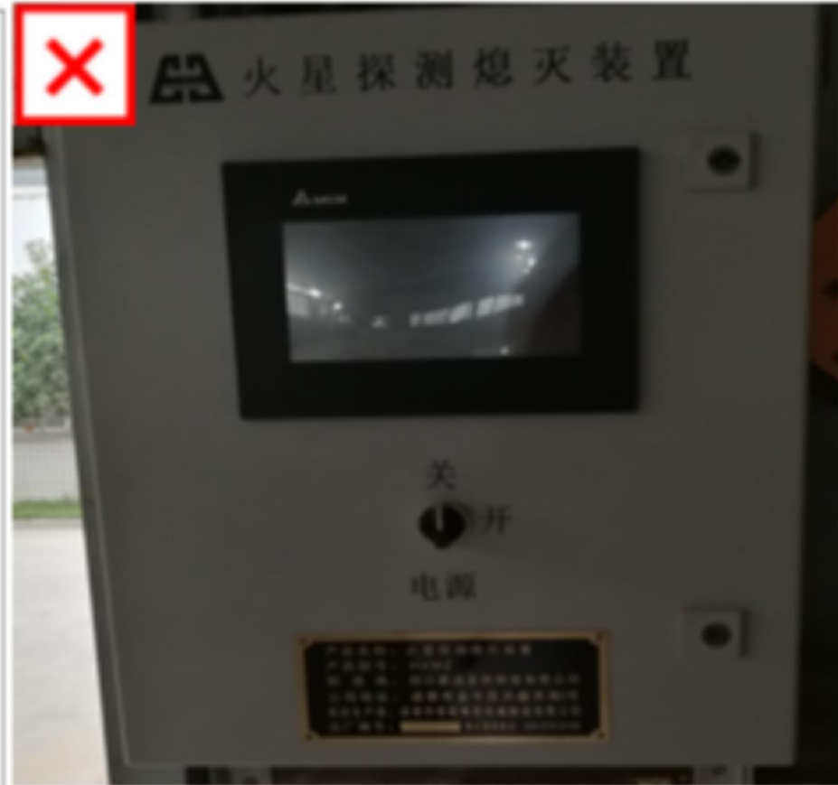
粉尘涉爆企业使用火花探测器未投用 判定为重大隐患
