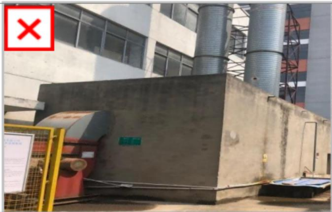
采用重力沉降室除尘
