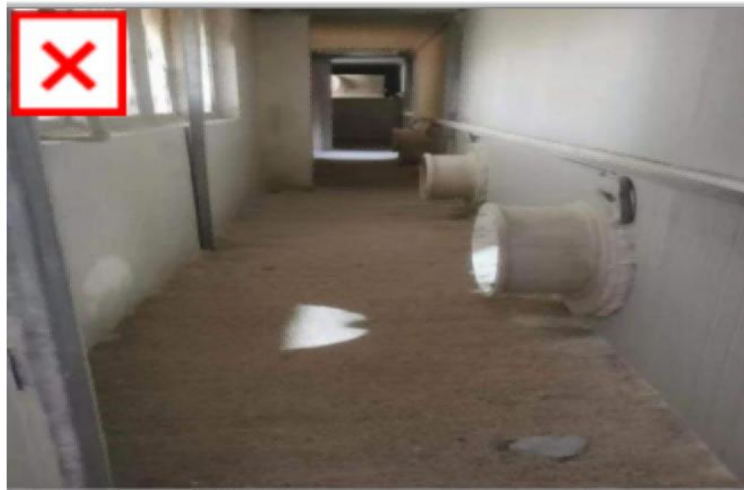
巷道作为除尘风道
