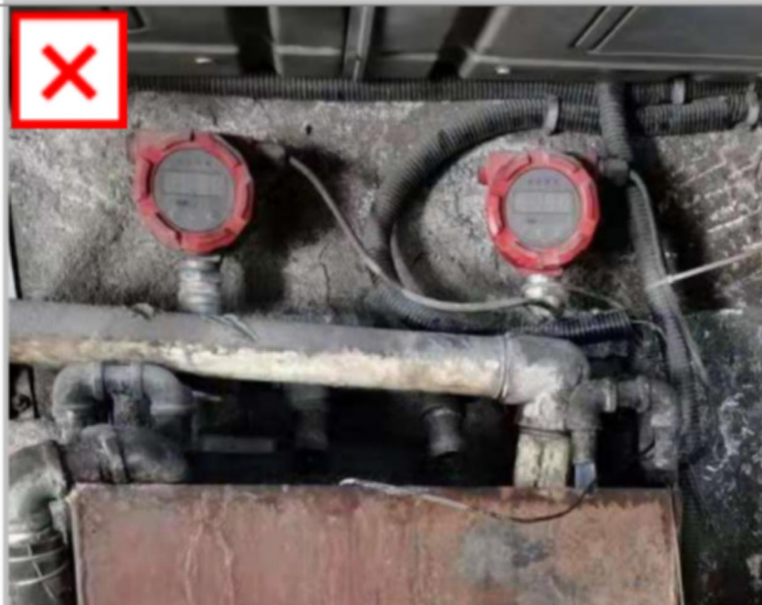
熔融金属炉窑冷却水流量差未投用 判定为重大隐患
