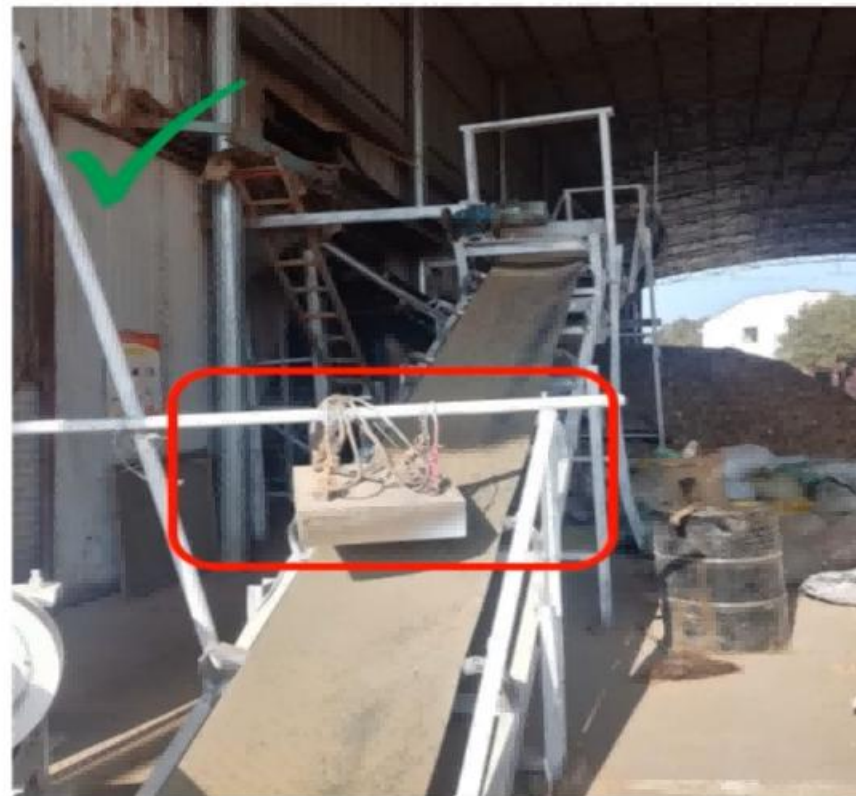
粉碎前安装有除铁器
